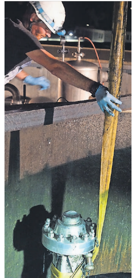
Die Bruchstelle der Welle.
